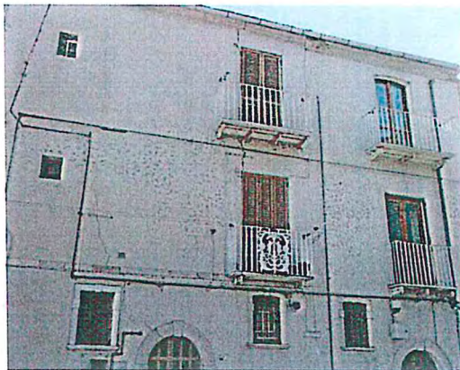
Monitoraggio lesioni fabbricati. Fessurimetri con acquisizione in tempo reale
