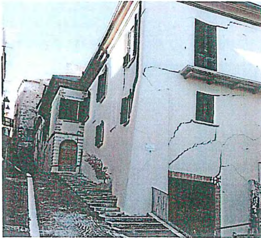
Lesioni ai fabbricati
